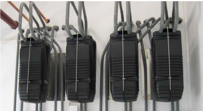
Vulcans instalados espalda contra espalda.
